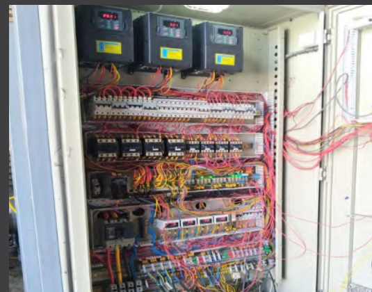
راه اندازی پایلوت پروژه تولید اسید لاکتیک
